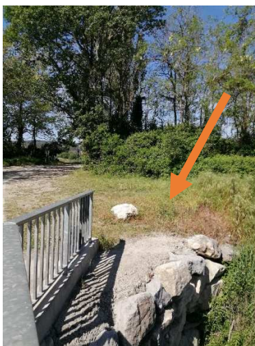
Photos des emplacements des deux placettes de part et d'autre du pont cadre au-dessus de la lône de la Grange écrasée à Bourg-Saint-Andéol.
